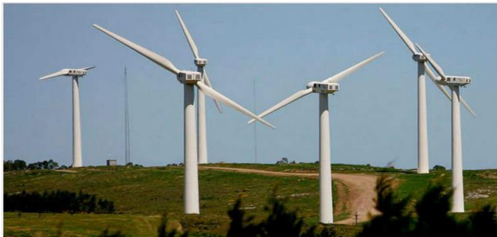
Figura 2-18. Parque Eólico Ventus
